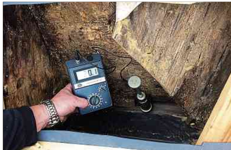
Die Techniker der Gemeinde Strassen haben Messungen und Analysen zwecks Ursachenforschung durchgeführt.
