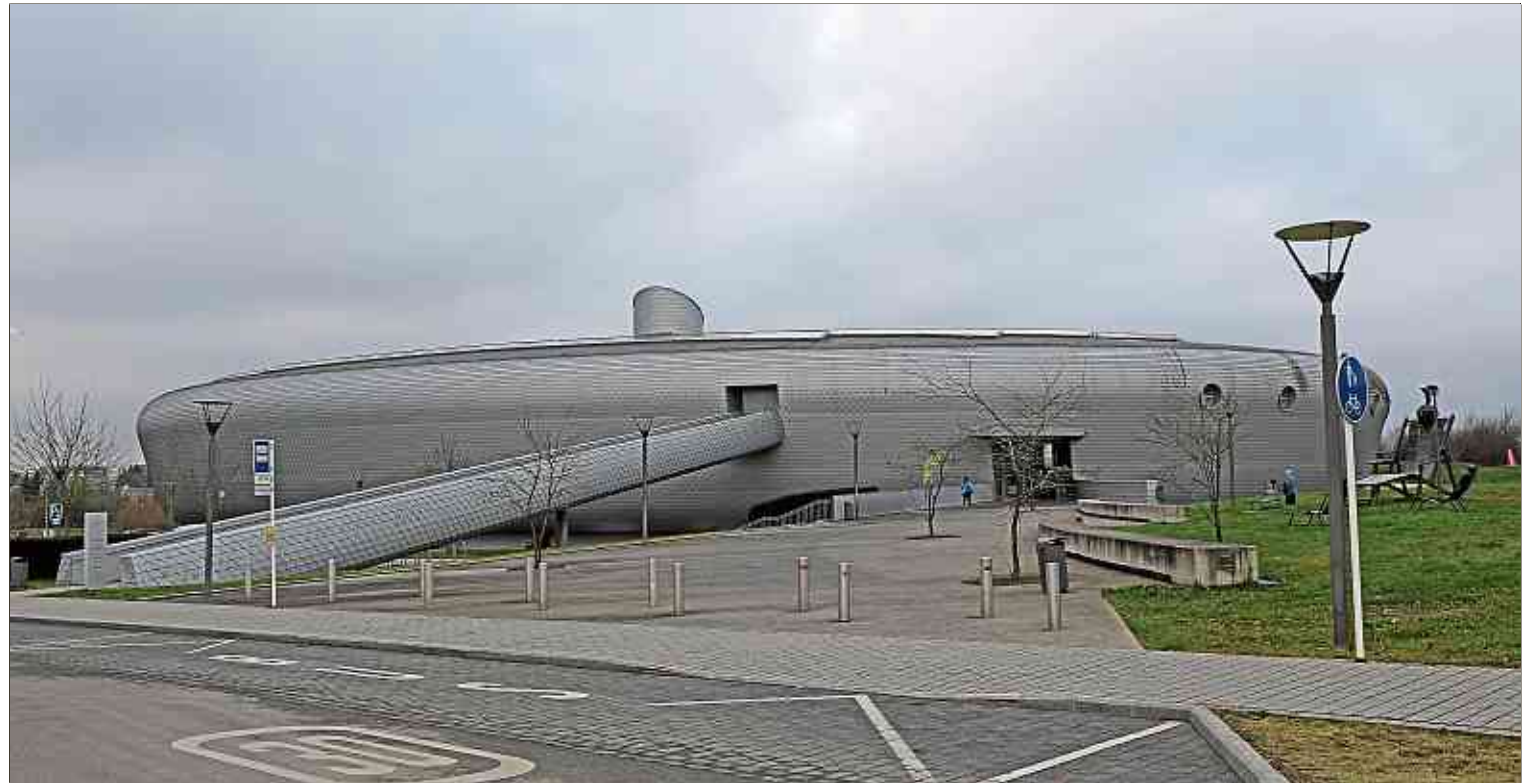
Erst 2009 wurde das Wellnessbad eingeweiht, nun wurden erhebliche Schäden am Dach festgestellt.
